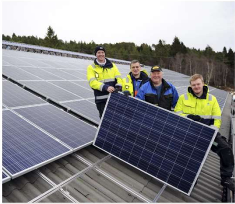
Får strøm fra 276 solcellepaneler
