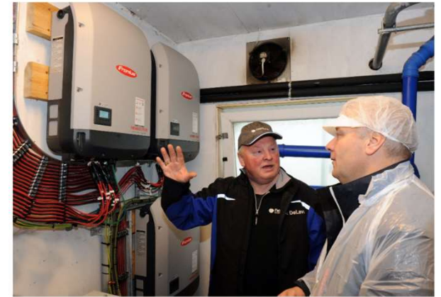
Solcelleanlegget på Rånes imponerte Hoksrud
